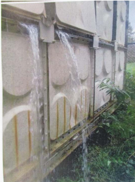
受水槽破損。パネル接合部より多量の漏水。 (地震直後の写真：管理者より提供)
