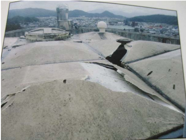
高置水槽天板パネル破損。 (地震直後の写真：管理者より提供)
