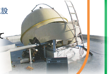
被害のあった高置水槽
